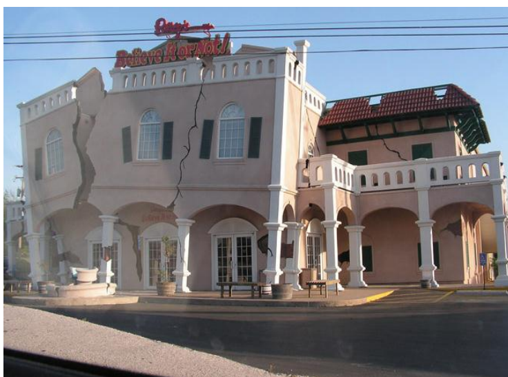
1.59. Дім з тріщиною. Онтаріо.
