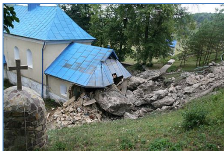
Фото. 14. Рукомиш. Скеля обвалилась на церкву. 30.07.2012, фото provse.te.ua
