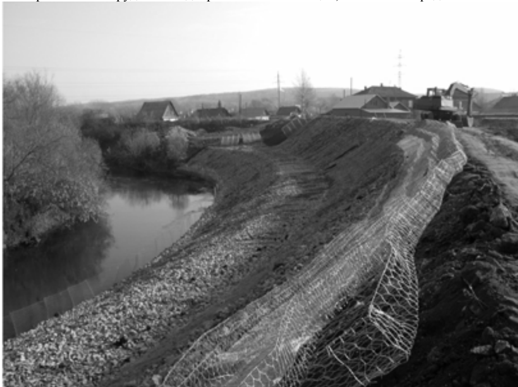
Рис. 3. Берегоукрепление в виде габионных конструкций на р. Шаква в г. Кунгуре
